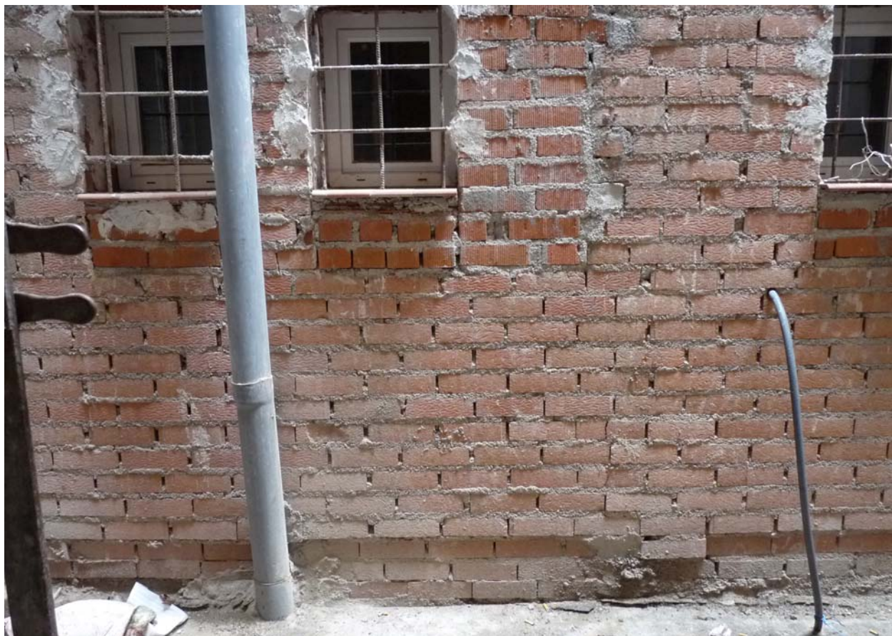
Imagen tomada el 1 de marzo de 2014 de las obras de rehabilitación inconclusas que están afectando negativamente a la habitación interior del Salón Montano. Fotografías: VPAT.
