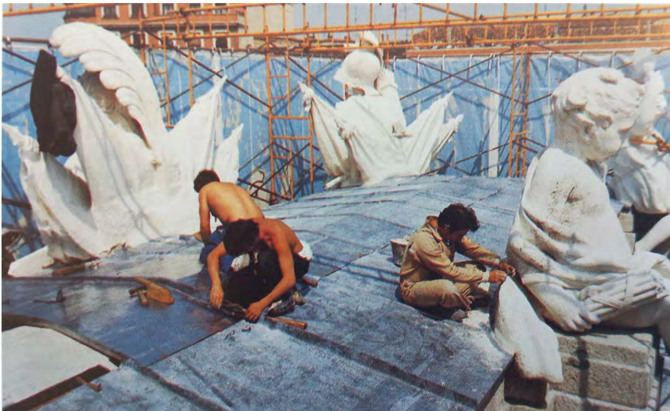
Fig. 177- Anónimo: Montaje de la cubierta de plomo en una de las cubiertas laterales , 1992. Fotografía publicada en La Puerta de Alcalá. Su historia, su restauración. El Corte Inglés, Ayuntamiento de Madrid. Madrid, Lagra, S.L., 1993.
