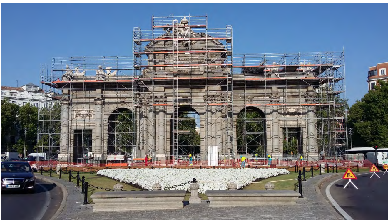
Fig. 182- VPAT: La Puerta de Alcalá el 15 de julio de 2022, con el andamio montado para ejecutar los trabajos de toma de datos de cara a su inmediata restauración.
