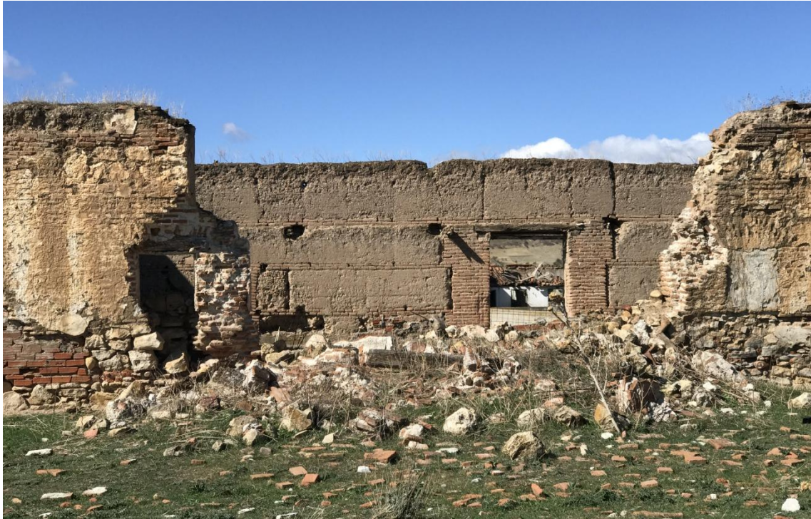
Derrumbe de fachada exterior y vista muros interiores del Caserío de Silillos. Daniel Sánchez García.
