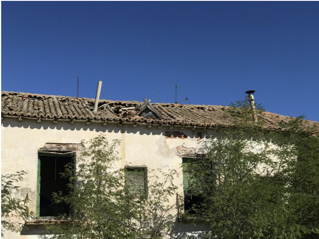
Derrumbe de una estructura sobresaliente del tejado del Palacio del Duque de Ega
