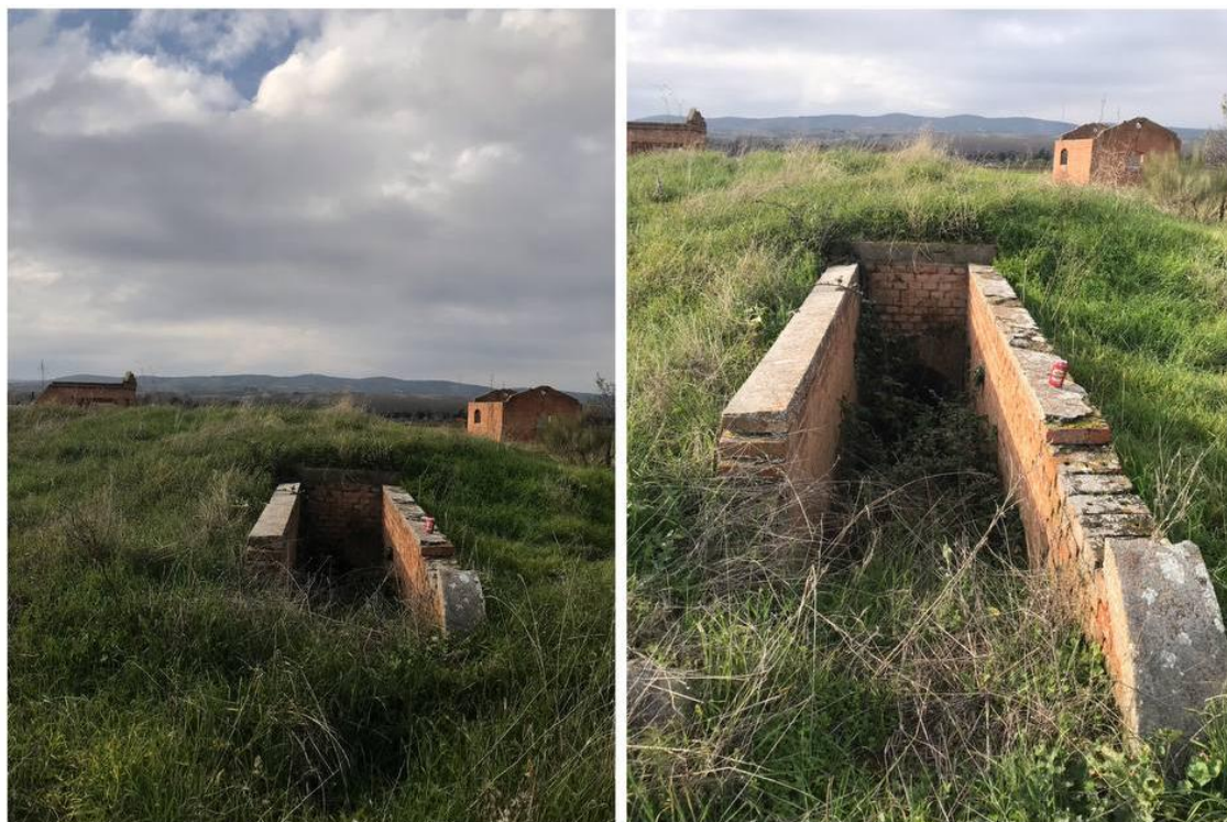
Figura 13. Imágenes de las escaleras de acceso –arriba/norte y abajo/sur- a la galería subterránea. (Daniel Sánchez García).
