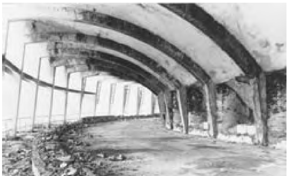
El pabellón antes de su desaparición. Proyecto de demolición, s/f. Archivo IFEMA. Inédito.
