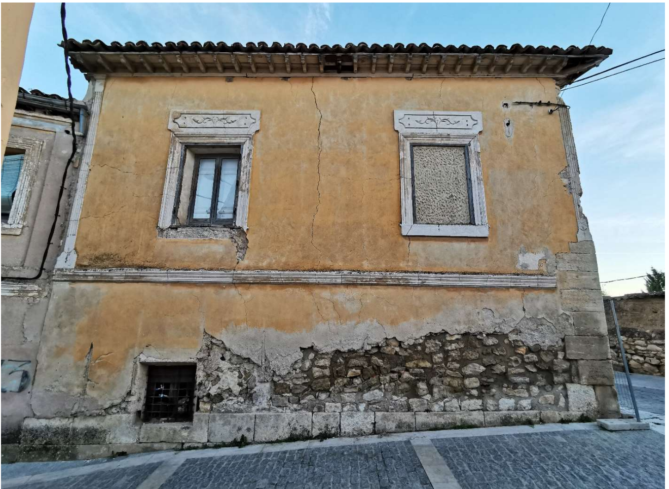
Imagen: Fachada lateral de esta crujía del siglo XVIII que da a la calle Yedra
