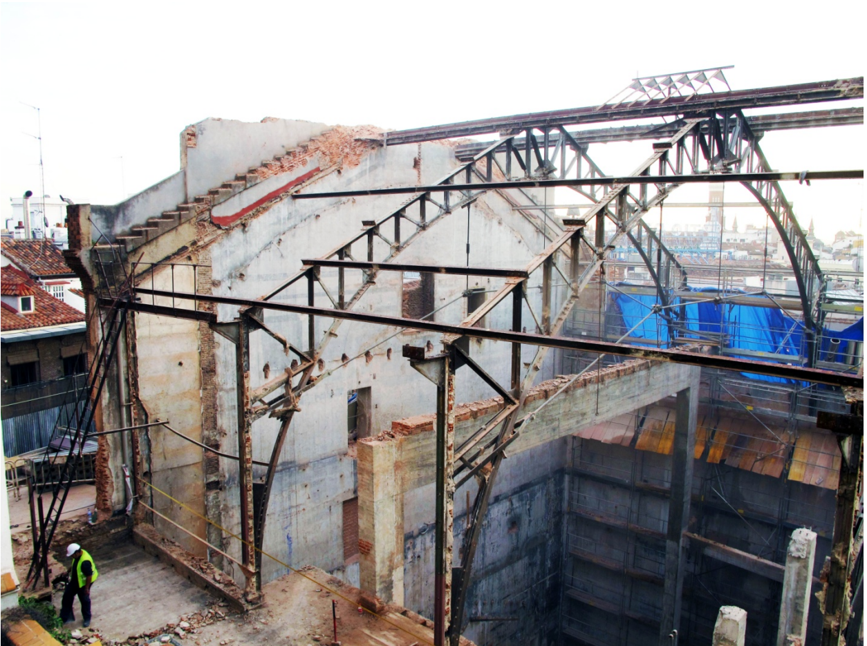
Fig. 105 - Vista en detalle de la soberbia estructura de cerchas roblonadas. Foto MCyP. Noviembre de 2014.
